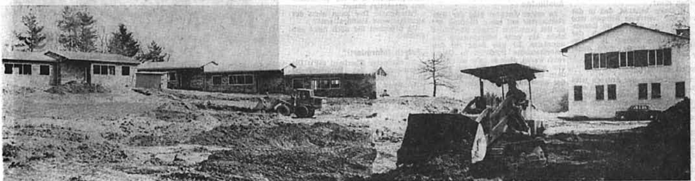
Nächst dem Turnersee in Kärnten entsteht das Feriendorf von Kinderland Steiermark. In den letzten Wochen sind zum großen Hauptgebäude, das im Vorjahr errichtet wurde, fünf von den zwölf für den Vollausbau geplanten Bungalows dazugekommen. Viel Arbeit wurde von freiwilligen Helfern aus den Industriebezirken durchgeführt. Das notwendige Geld wird durch Sammlungen und mit Unterstützung von Betriebsräten, Gemeinden, öffentlichen Stellen und der Arbeiterkammer aufgebracht (S. 5).
